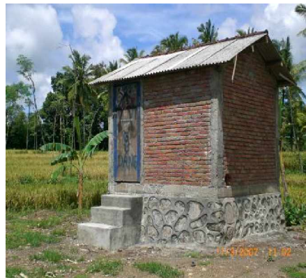
Rumah mesin pompa
